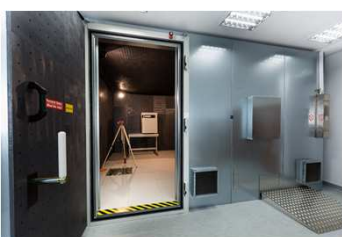
Ryc.1 Komora bezodbićcowa. Zamknięte, metaliczne przesłanianie do ochrony przed promieniowaniem elektromagnetycznym.
